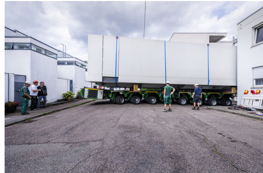
In kurzer Zeit wurde das von Werner Sobek geplante Aktivhaus abgebaut und auf den Schwertransporter verladen. Das temporäre Versuchsgebäude ist ein Musterbeispiel für modulares Bauen mit vorgefertigten Elementen. Foto: René Müller
